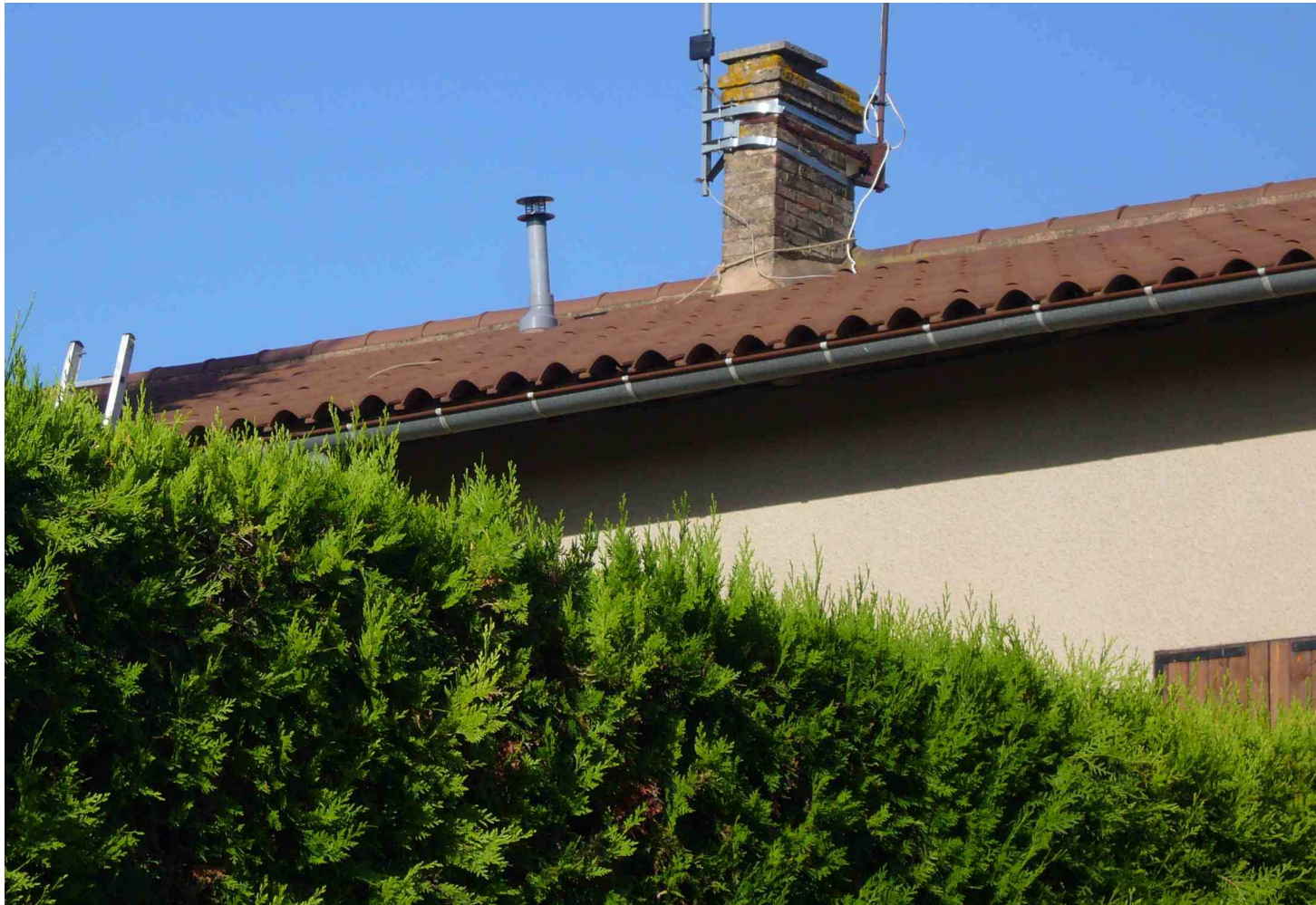
Extracteur statique dépassant de 40 cm le faîtage du toit
